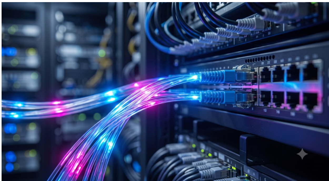
Fibra óptica e interconexão: o tecido físico que conecta operadoras, nuvens e parceiros
